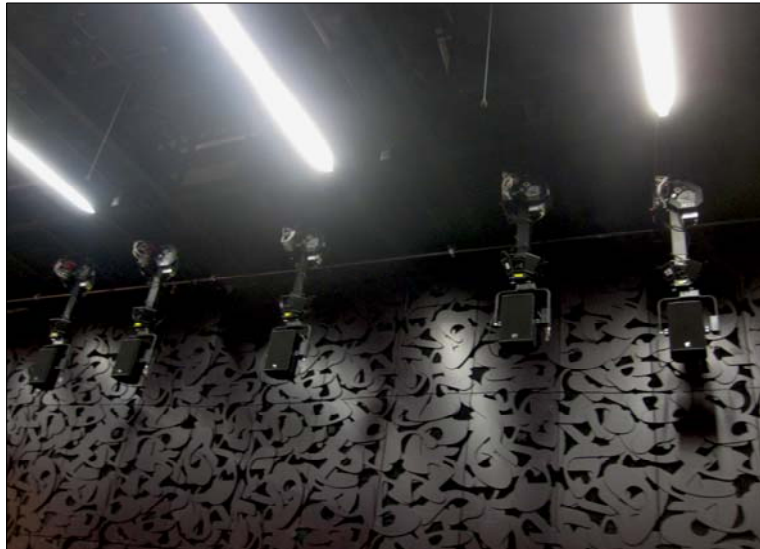
Abb. 3.6: Beschallungssystem des MUMUTH Graz
