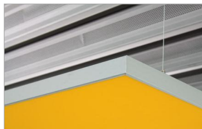
Abbildung 10: Farbige Deckensegel aus Melaminharzschäum mit Alurahmen [SCHAUMSTOFFLAGER]
